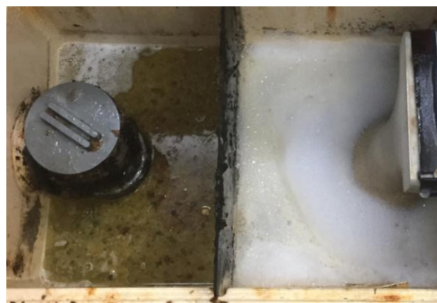
左は油が堆積、右は油の上に洗剤の泡、右端は残渣用ネット
